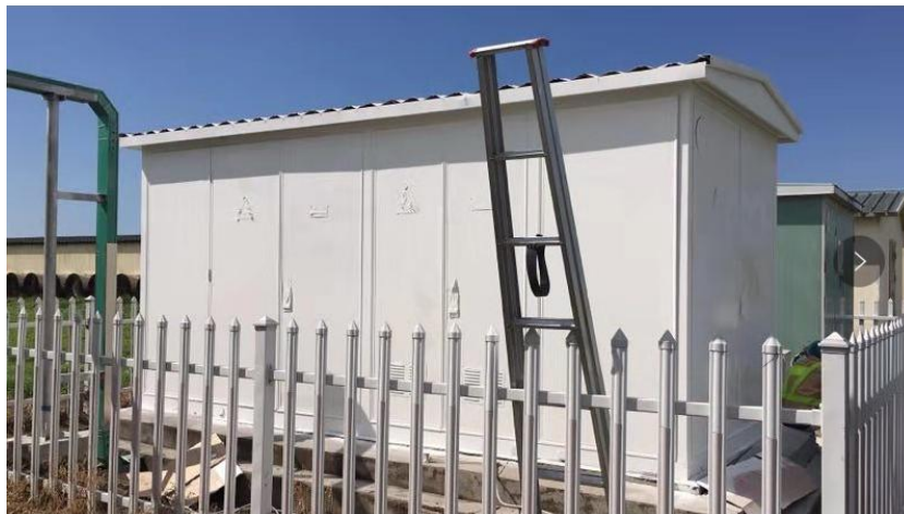
Rysunek 2-5. Przykład zastosowania powłoki radiacyjnie chłodzącej na szafie elektrycznej w Xi'an.
