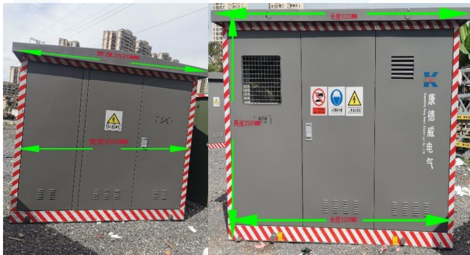
Rysunek 2-1. Przykład zewnętrznej szafy elektrycznej China Southern Power Grid
