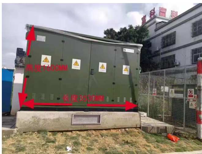
Rys. 2-8. Zewnętrzna szafa elektryczna
